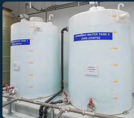
DRINKING WATER TANKS ถังเก็บน้ำดื่ม
